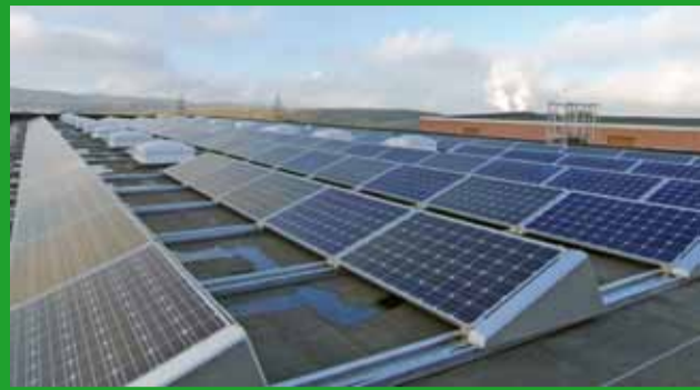
Kooperativ Photovoltaikanlagen Systèmes voltaïques à base coopérative
